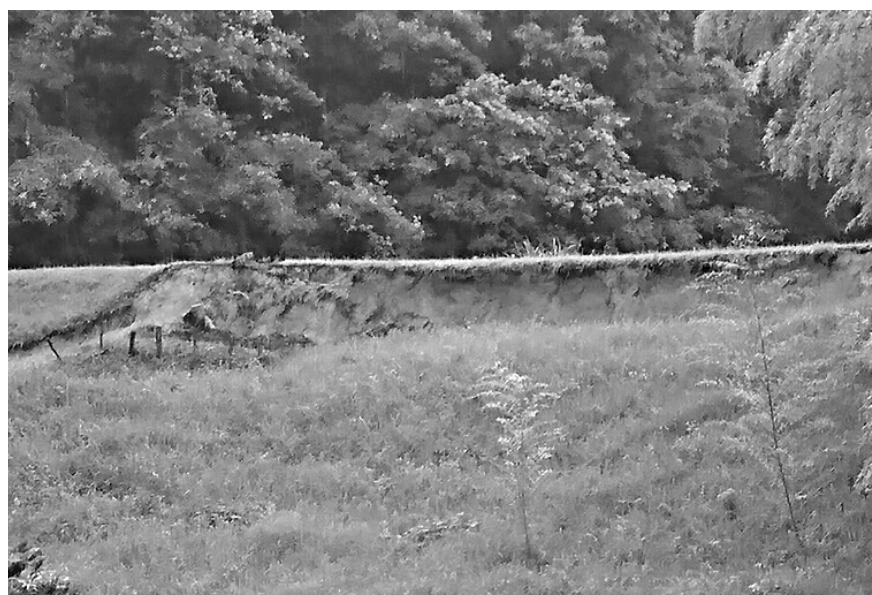
崩れたため池の堤防(古井地区)
