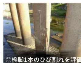
◎橋脚1本のひび割れを評価
