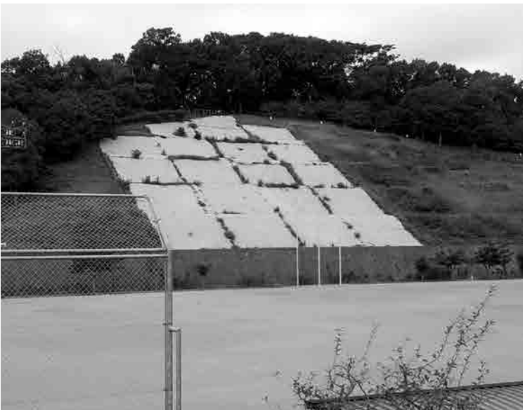
法面崩落現場
