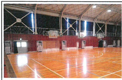
屋内運動場冷暖房設備
