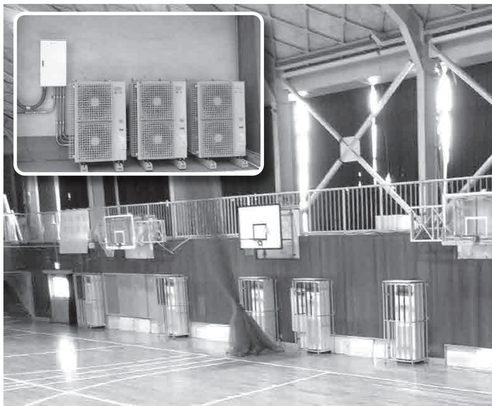
中学校体育館に設置された空調設備
