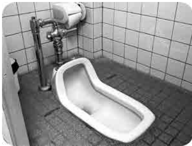
小学校トイレの現状
